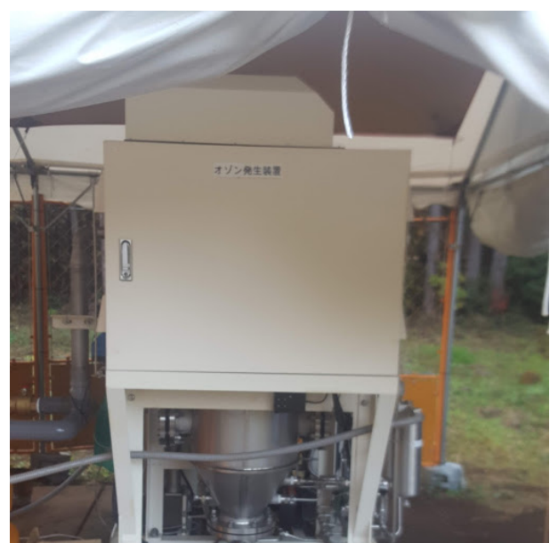
写真 18 オゾン発生装置
