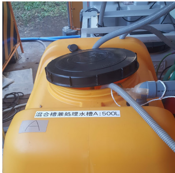
写真 15 混合槽兼処理水槽 A
