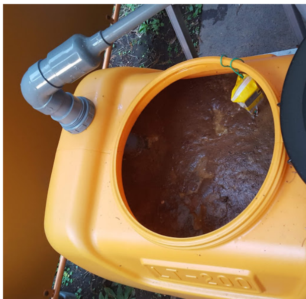
写真 7 固液分離槽内部
