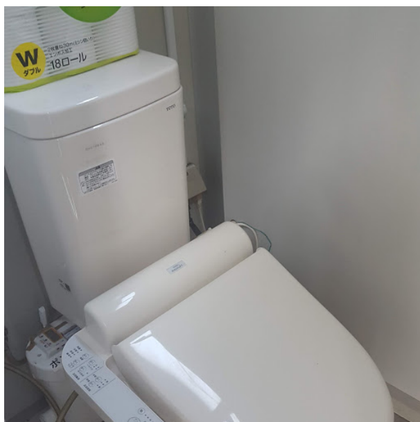
写真 5 温水洗浄便座
