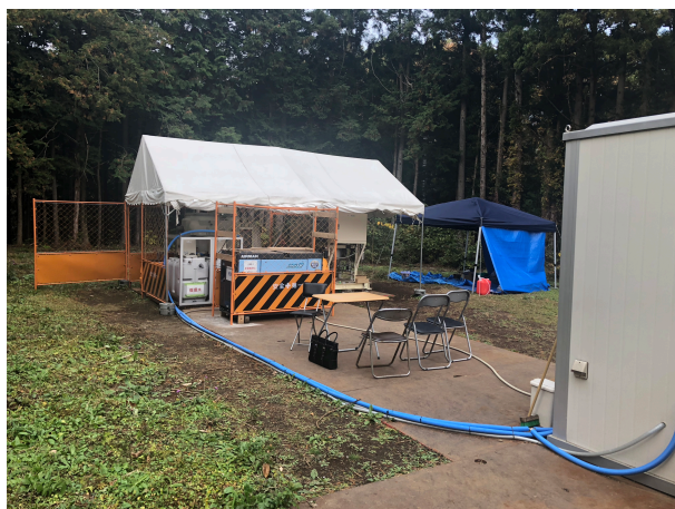
写真 1 処理装置外観（遠望）
