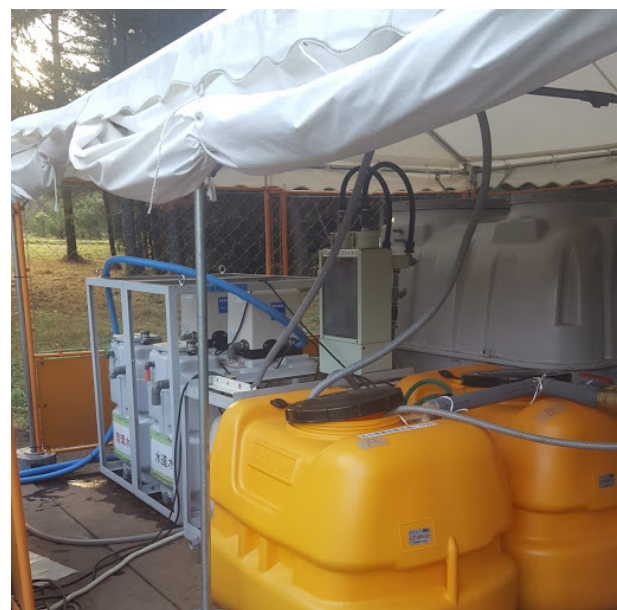
写真 14 混合槽兼処理水槽 A, B
