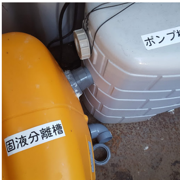
写真 9 固液分離槽からポンプ槽へ
