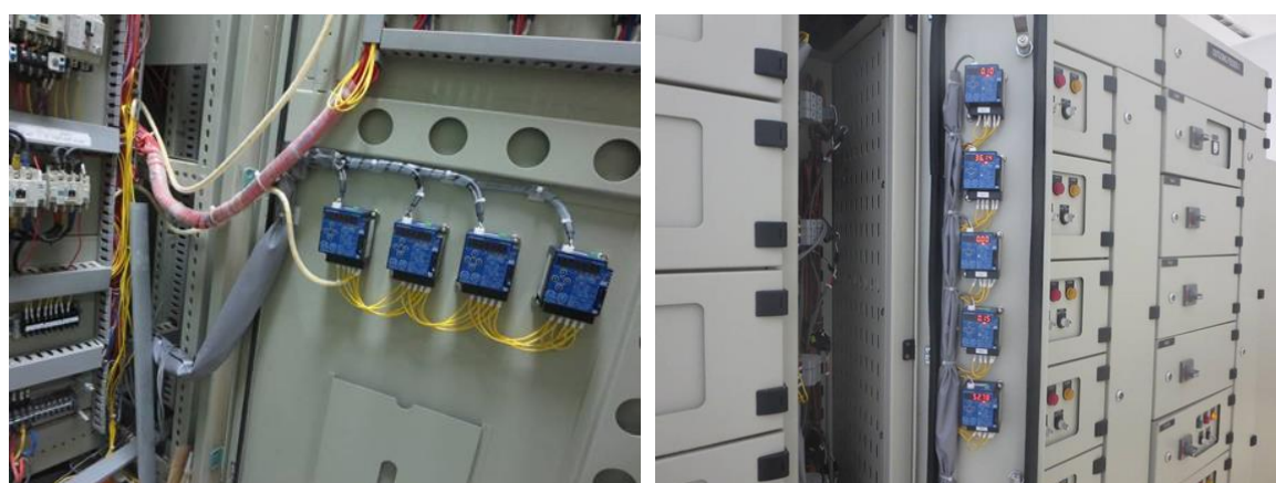
図 電力量の測定（左：C工場排水処理場、右：D下水処理場の積算電力量計）
