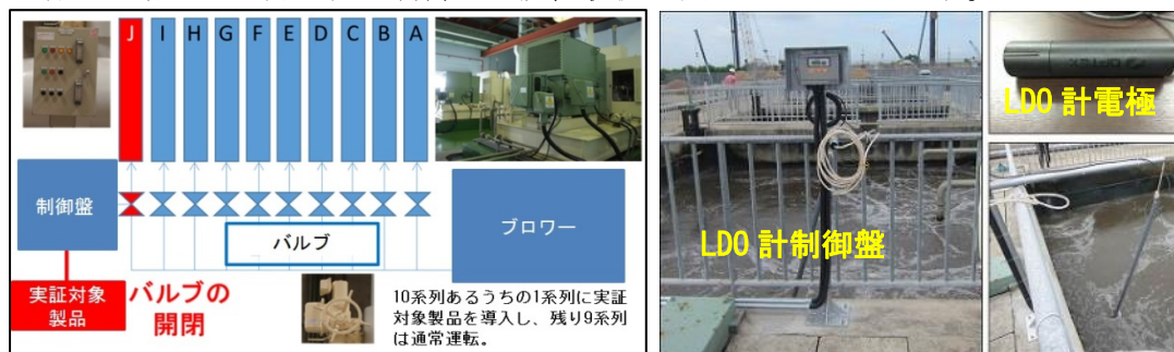
図 3-4 A 下水処理場における実証対象製品の設置の概要と状況
