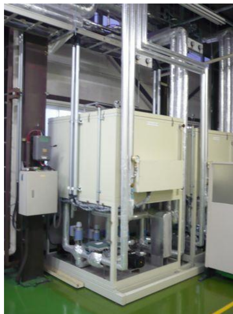
写真 4-6 一次側熱媒(水)の定温設定用の水タンクとポンプ、流量計(試験室外に設置)
