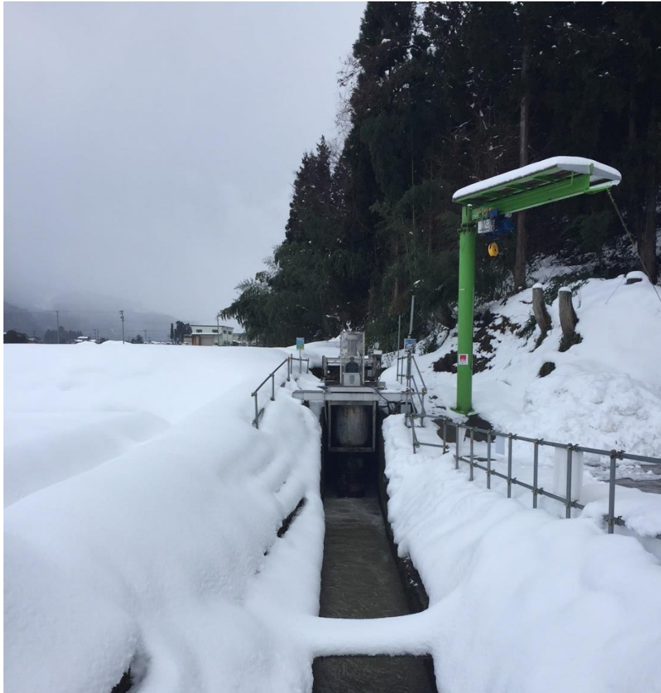
写真 6-1 発電設備の概観
