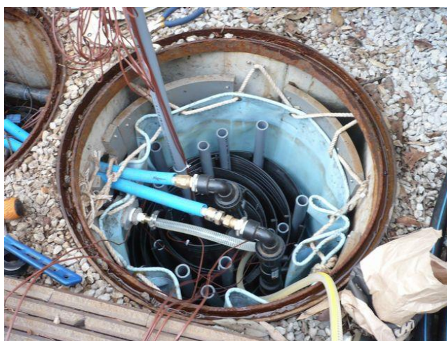
写真3 タンク式地下水熱交換器の内部
