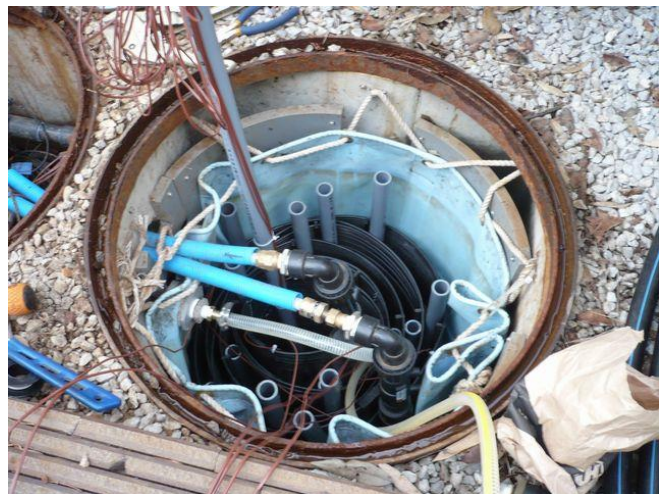
写真3 タンク式地下水熱交換器の内部
