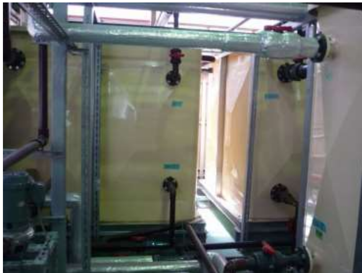
写真 4-4 温水タンク、冷水タンク
