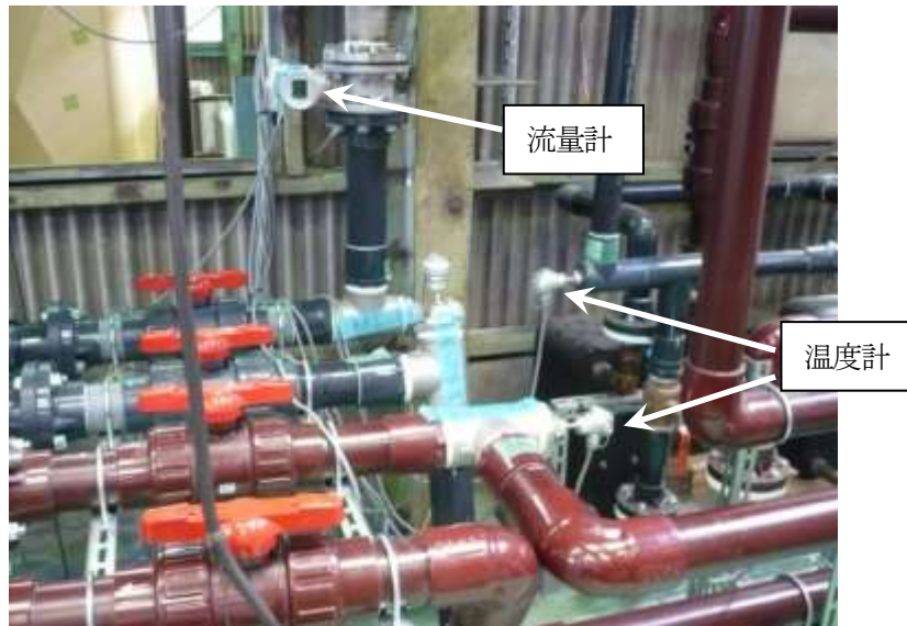
写真 4-3 試験設備の温度計、流量計など
