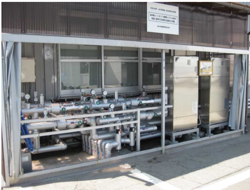
写真3 ヒートポンプと配管、計測器
