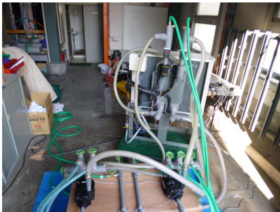
写真 4-3 試験設備の配管の状況
