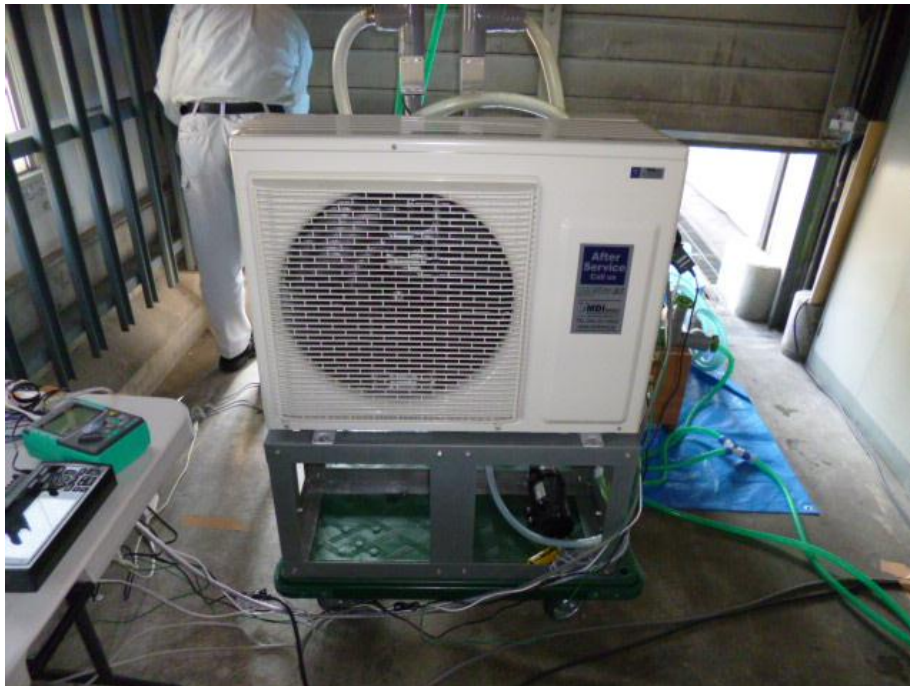
写真 4-1 実証試験中の実証対象技術のヒートポンプ
