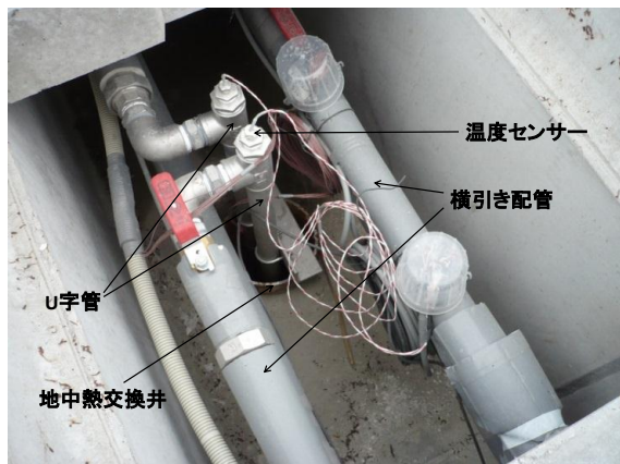
写真3 地中熱交換井の口元
