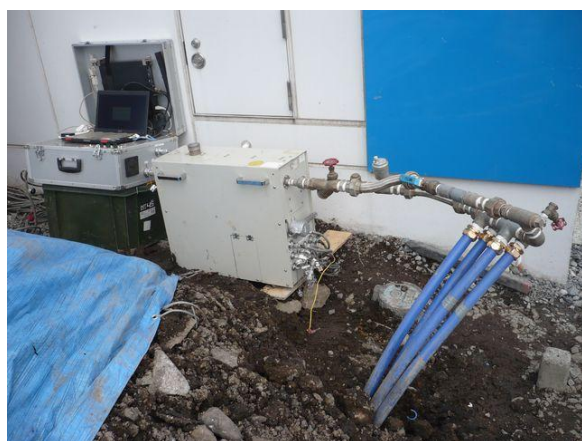
写真3 加熱循環配管の状況
