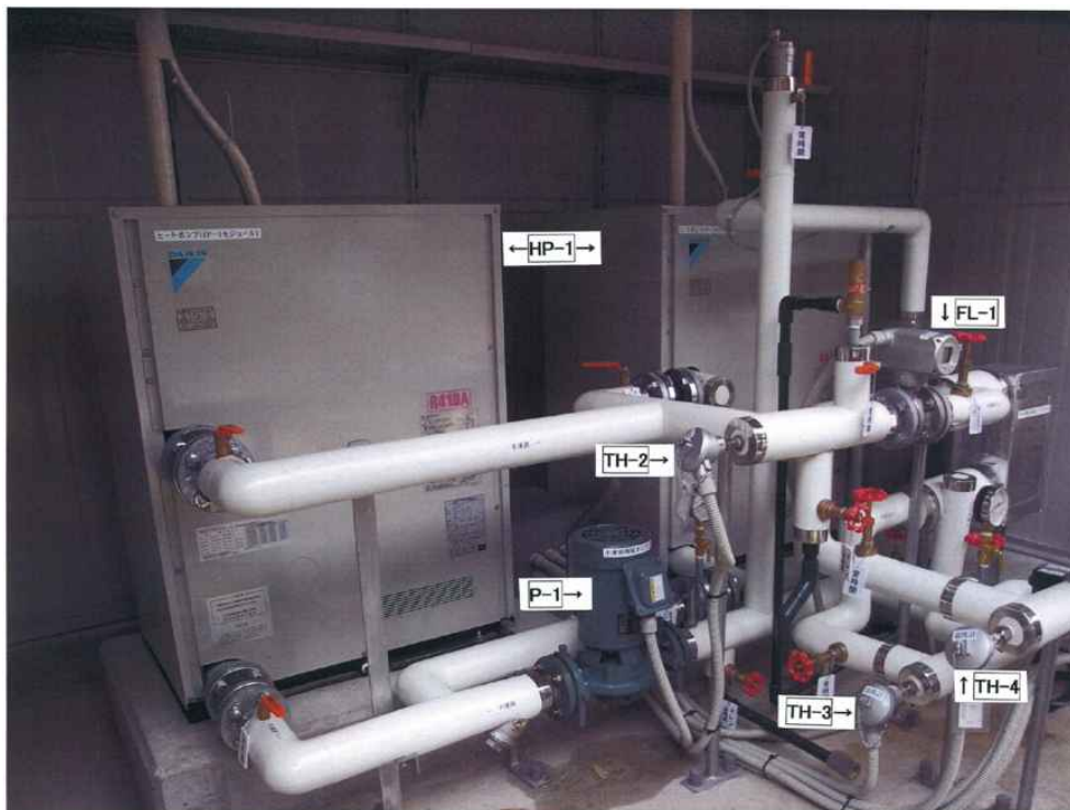
図 4-3 実証試験実施設備の設置状況
