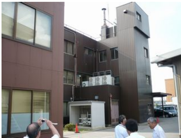
図 3-6 本社社屋とヒートポンプ設備 （一階の地面に置いてある小屋の中）
