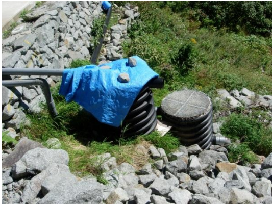
雨水混入防止対策のビニルシート (9月1日～、降雨時のみ従業員が設置)
