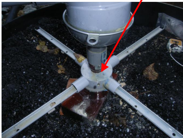
写真 6-2-4-1 分散装置の目詰まり 1
