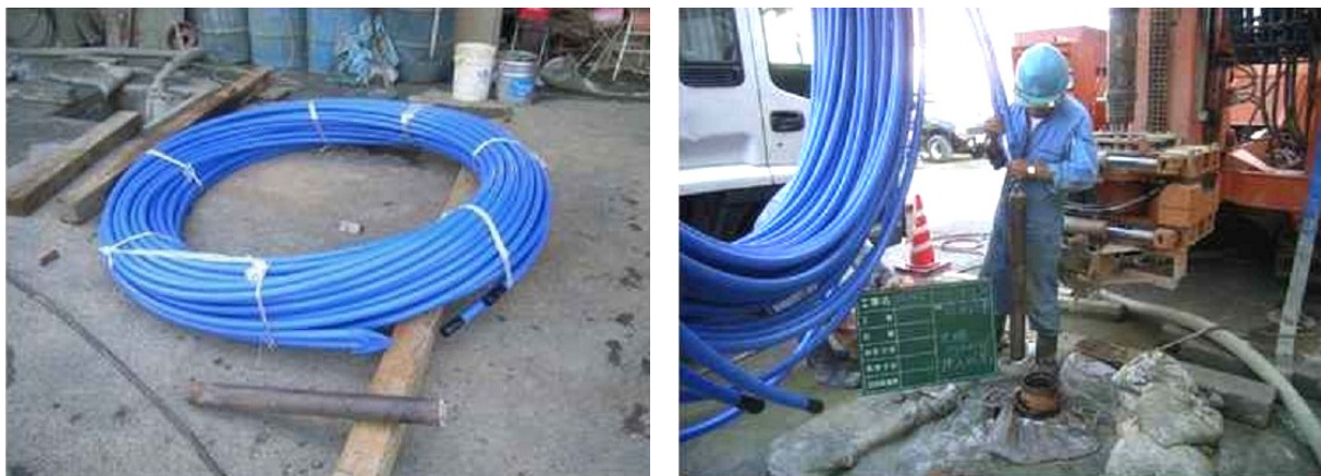
図 3-4 熱媒循環部（U字管）及び熱媒循環部挿入状況
