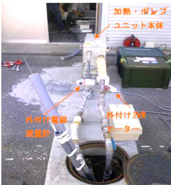
加熱・ポンプユニットと地中熱交換井の写真
