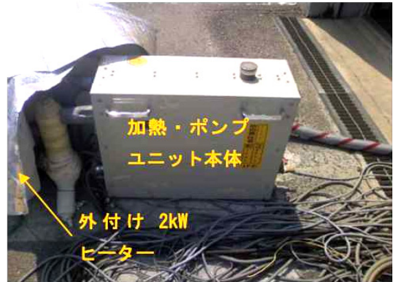
加熱・ポンプユニットの写真
