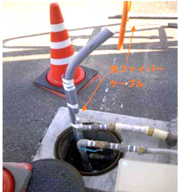
地中熱交換井と光ファイバーの写真
