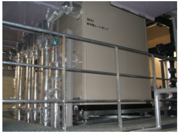
地中熱ヒートポンプ設置状況
