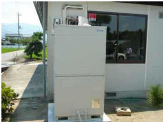
ヒートポンプと空調している部屋
