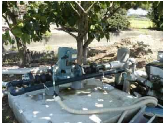
地下水の自噴井と循環ポンプ
