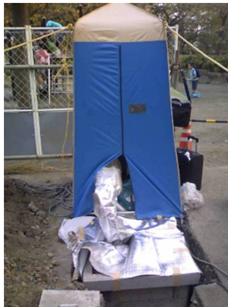
TRT 装置設置状況
