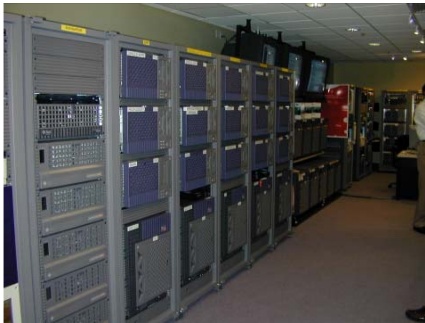
データセンター
