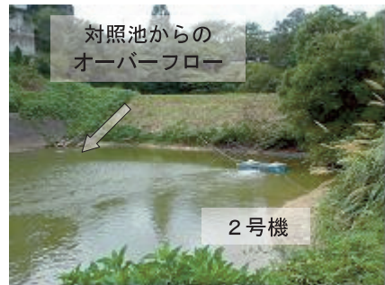
実証対象機器の設置状況
