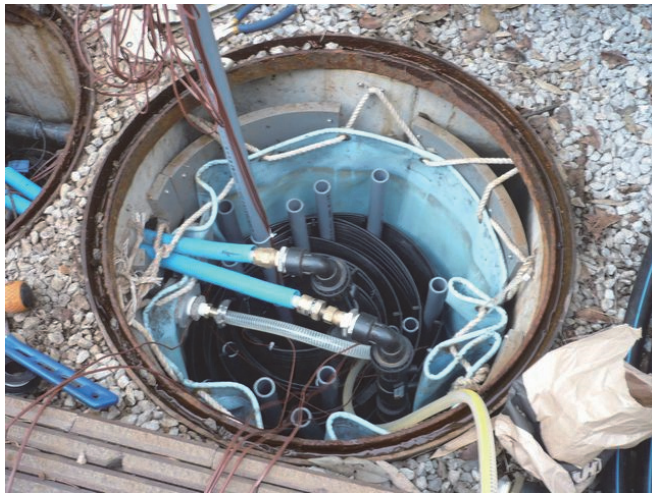
写真3 タンク式地下水熱交換器の内部
