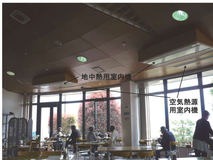
写真4 地中熱利用冷暖房をしているレストラン
