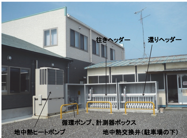
写真1 室外設備の全景
