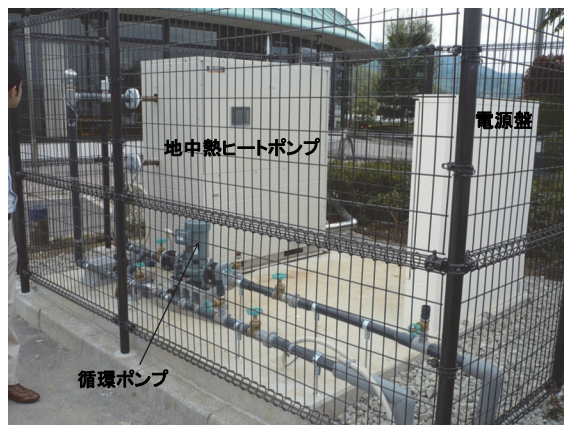
写真2 地中熱ヒートポンプと循環ポンプ
