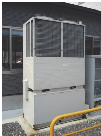
写真3 地中熱ヒートポンプ
