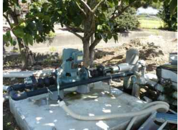
地下水の自噴井と循環ポンプ
