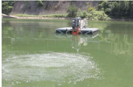
MSJ-150 縦型の設置運転状況
