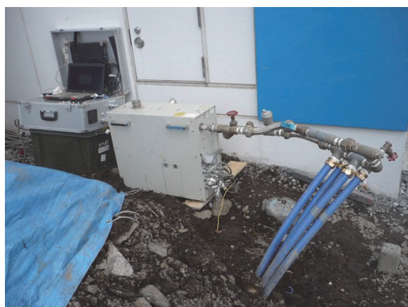
写真3 加熱循環配管の状況
