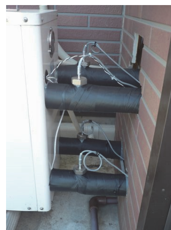
写真4 ヒートポンプ入口出口温度計
