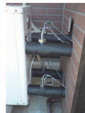
写真4 ヒートポンプ入口出口温度計
