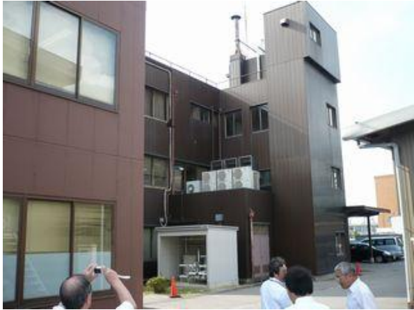
本社社屋とヒートポンプ設備 （一階の地面に置いてある小屋の中）
