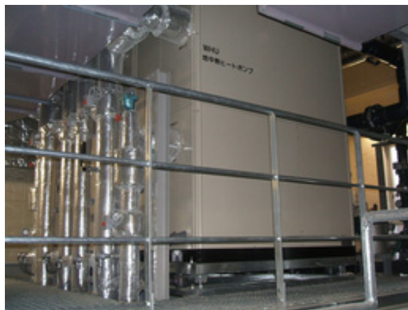
ヒートポンプ設置状況
