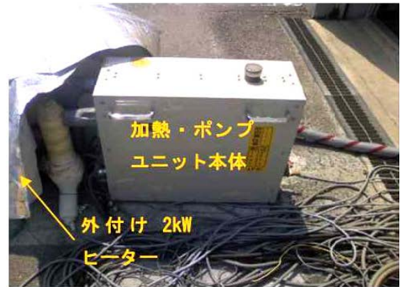
加熱・ポンプユニットの写真
