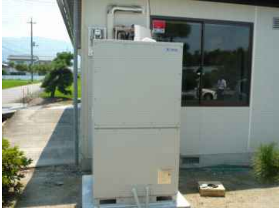
ヒートポンプと空調している部屋
