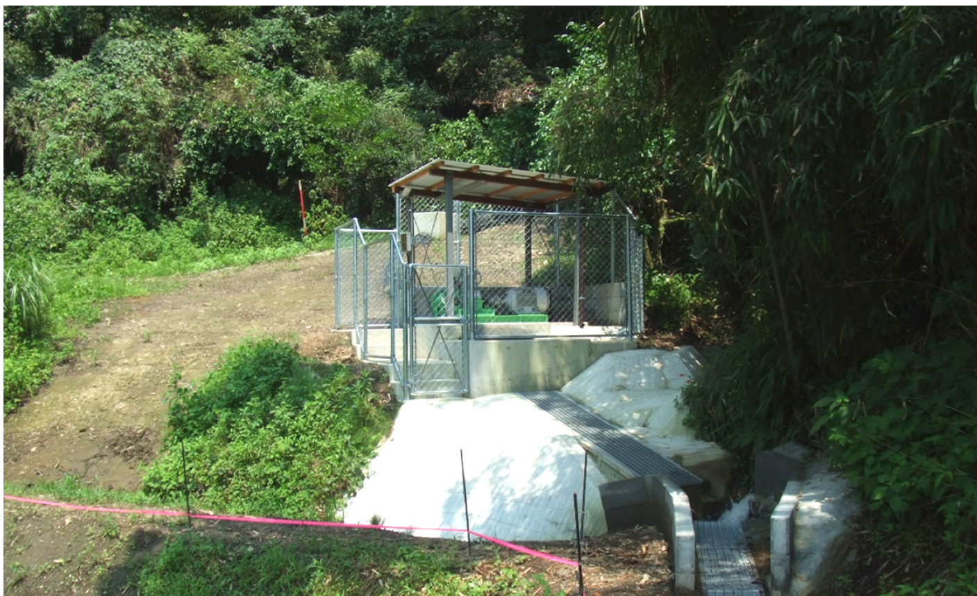
写真1 導入事例（宮ヶ瀬小水力発電所）
