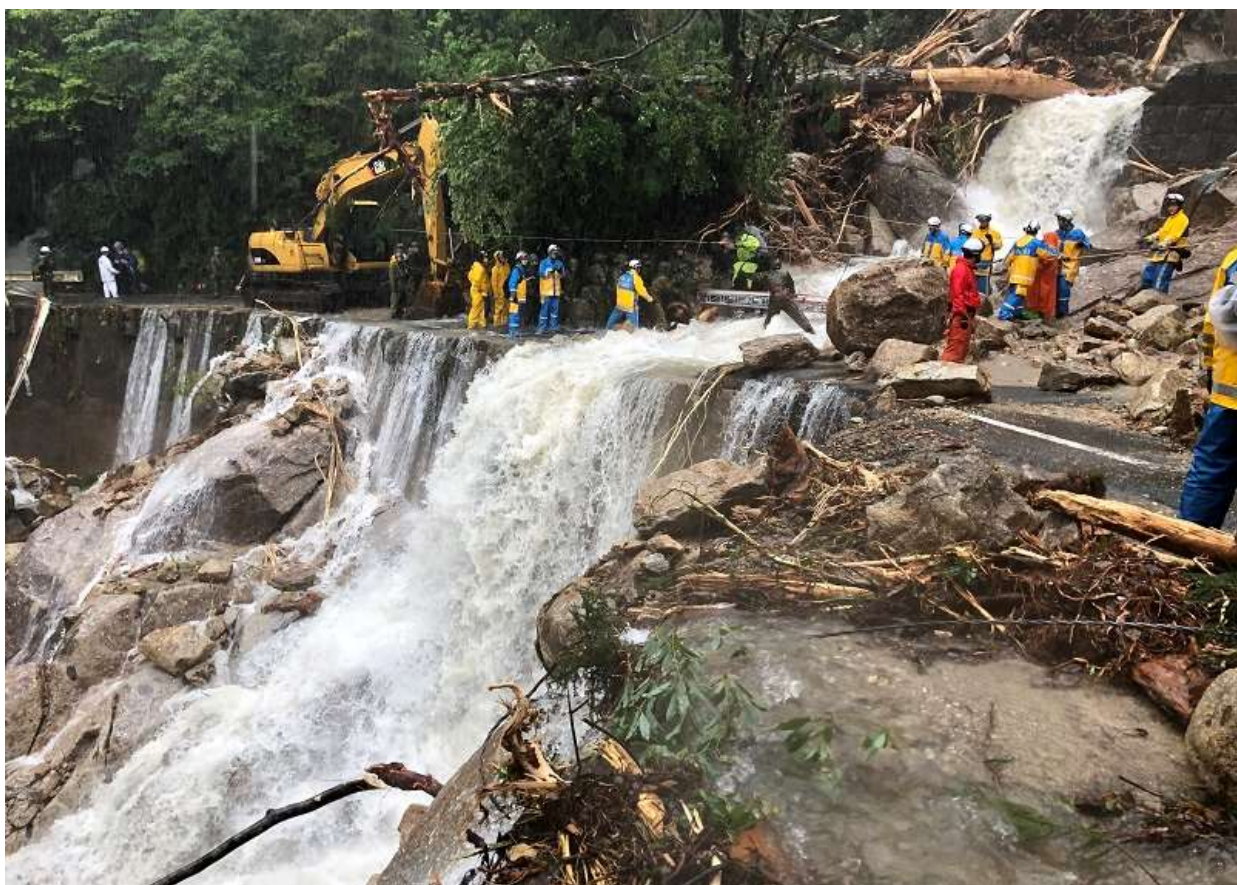
令和元年5月豪雨による被災
