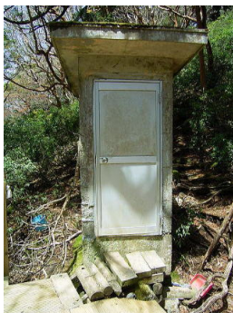
写真1:高塚避難小屋のトイレ
