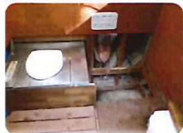
小杉谷バイオトイレ
