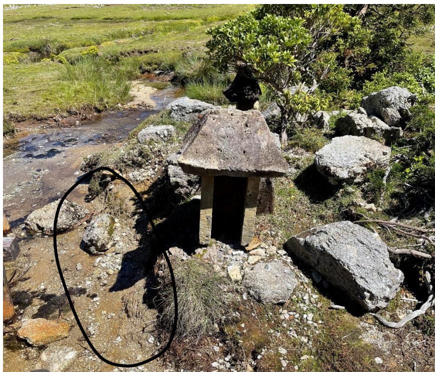
図 祠土台部分の浸食箇所（黒丸部分）
