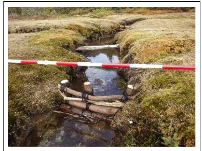
写真2 局所的に流路の侵食が発生
