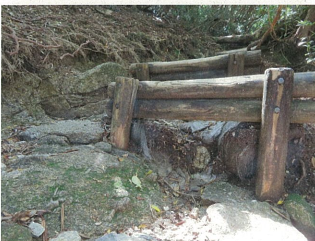
⑤ 歩道の下がえぐられて土砂が流れ出ている。
