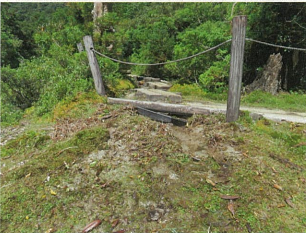
⑮歩道からの土砂の流入状況
