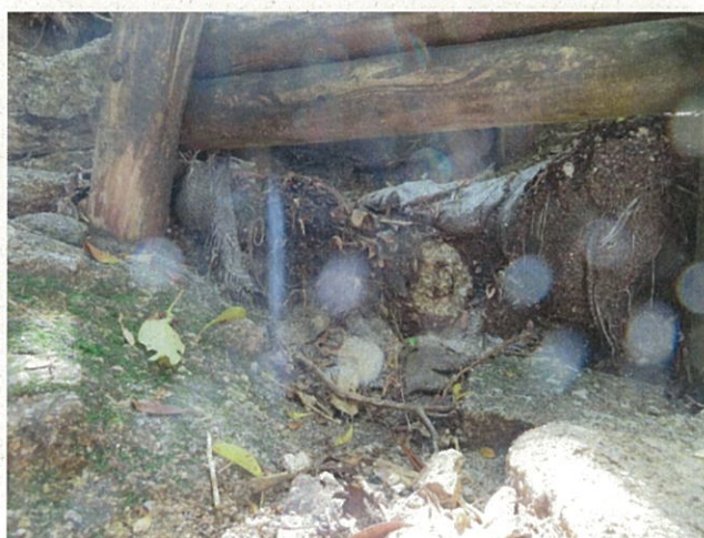
⑥ 土のうに詰めた土砂が破れて流れ出ている
