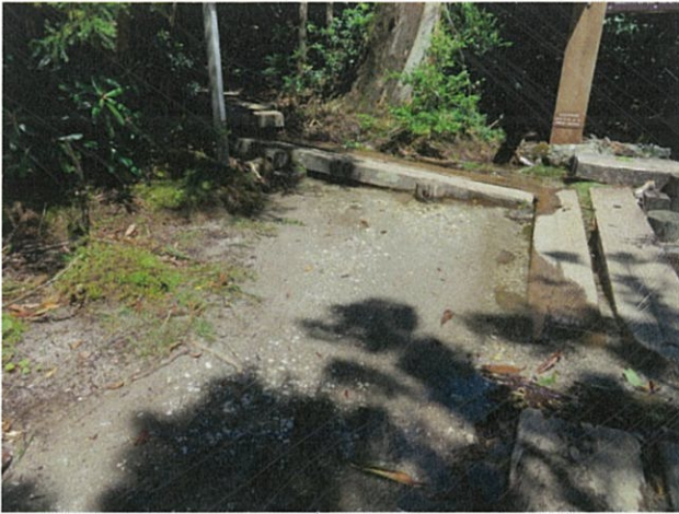
⑬歩道からの土砂の流入状況
