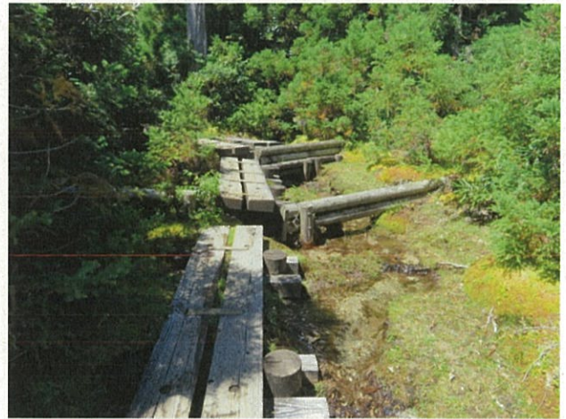
⑩歩道奥 歩道の下方がえぐられている
