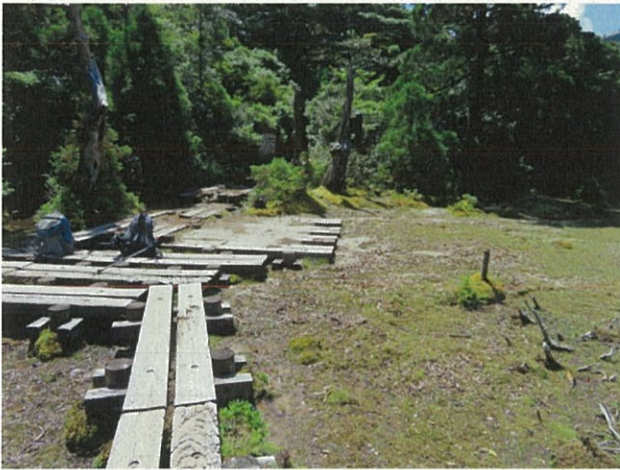
⑨歩道の奥から歩道入り口をみる 流入土砂が堆積している
