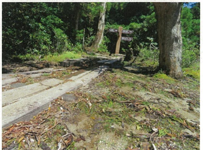
⑫歩道からの土砂の流入状況
