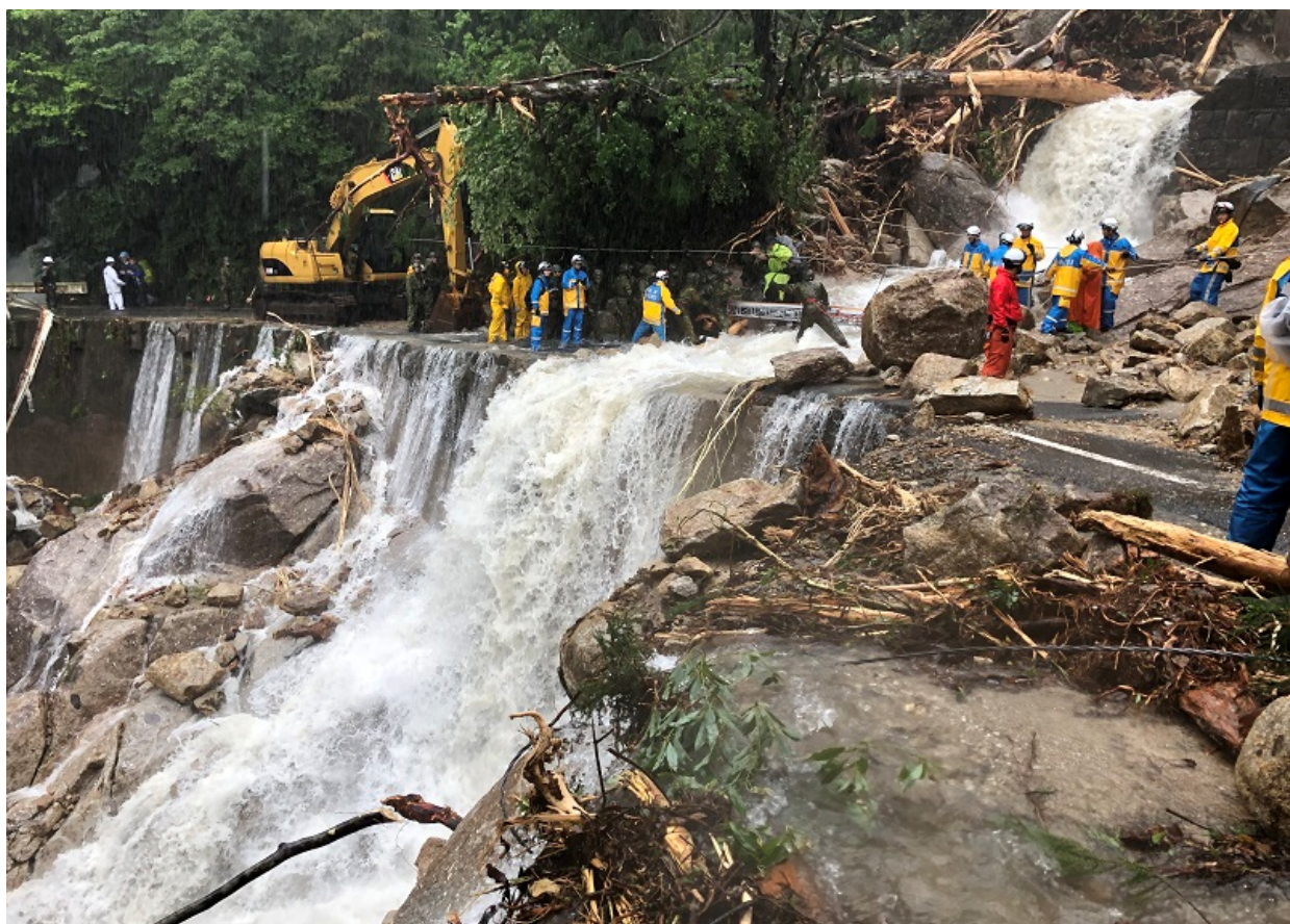
令和元年５月豪雨による被災
