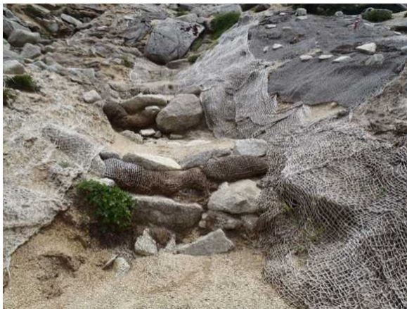
侵食部の底面周辺から植生が回復する
