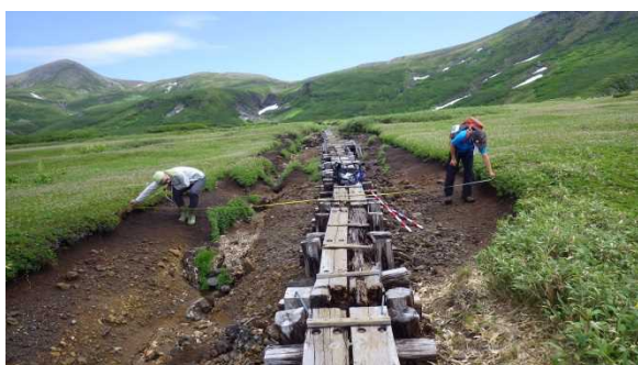
木道が老朽化し侵食も拡大 裾合平(2013. 8. 10)
