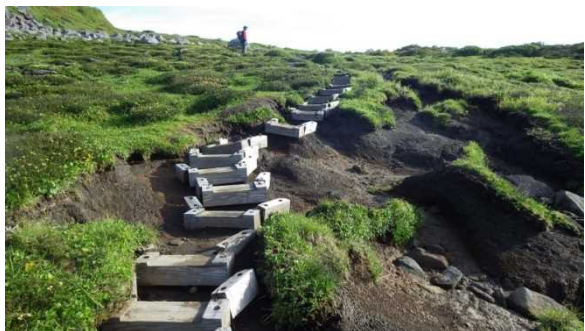
階段整備後も侵食が続く ヒサゴ沼付近 (2013. 9. 10)
