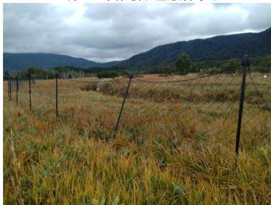
9月25日 支柱曲がり(点検番号3)
