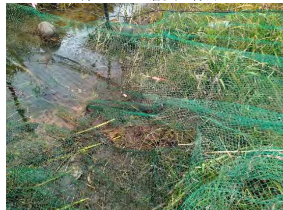
9月25日 ネット破損(点検番号4)
