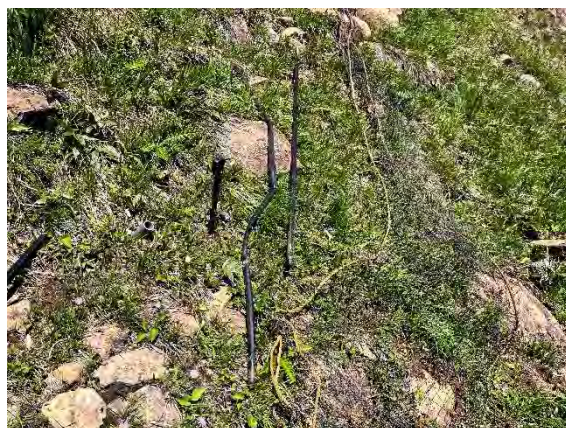
6月28日 変形した支柱と支柱ベース
