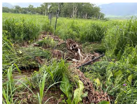
7月10日 支柱折れ(点検番号3)
