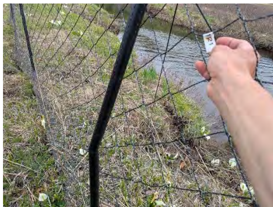
6月2日 支柱折れ(点検番号1)
