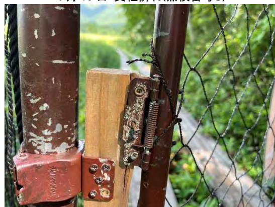
8月14日 扉の蝶番破損
