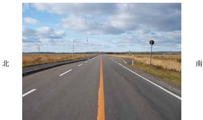
図 6.2.1 丸山道路の路面にみられる亀裂(原生花園側から丸山方向を望む)
