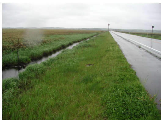
図 3.1.16 丸山道路側溝
