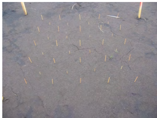
写真 6.1.43 №5 真上 7月 (設置時)
