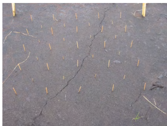
写真 6.1.31 №3 真上 7月 (設置時)
