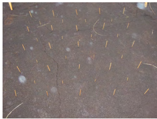
写真 6.1.25 №2 真上 7月 (設置時)
