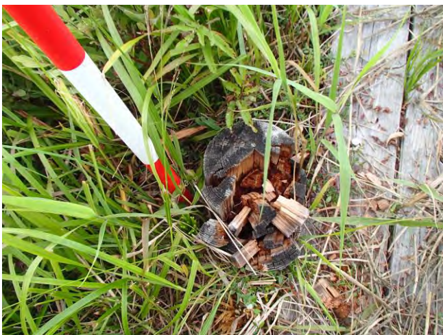
杭丸太の腐食の進行
