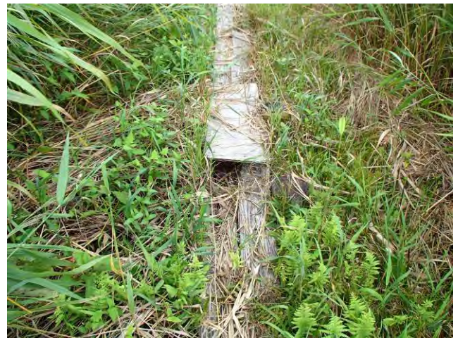
補修後の段差発生によるベニヤ板の浮き上がり
