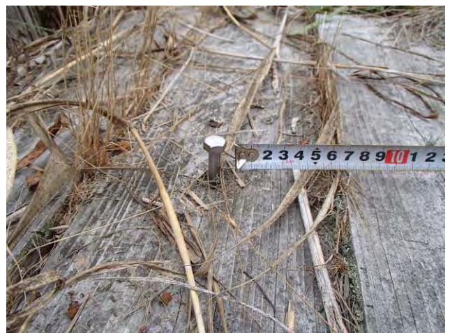
ボルトの浮き上がり
