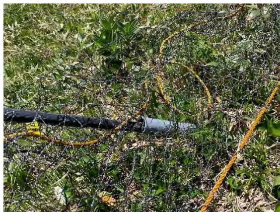
6月19日 変形した支柱ベース
