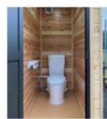
災害用トイレの整備
