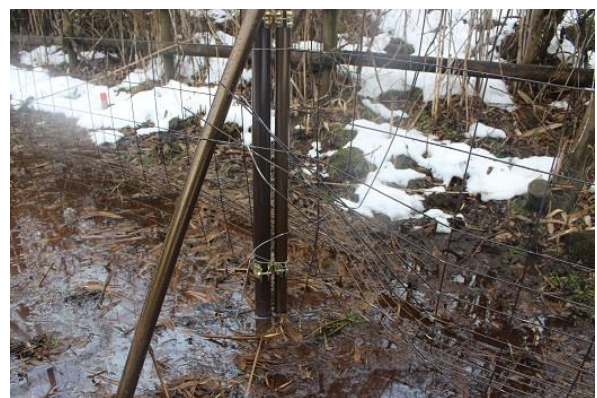
図 5-2-2 小規模な修繕に該当する例 パネルとスカートの穴（支柱は問題ない）
