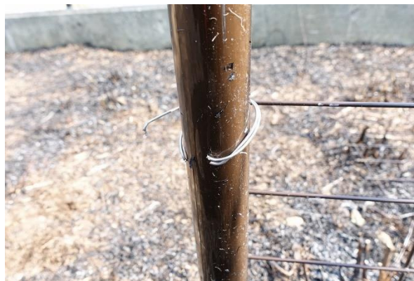
写真 3-2-2-10 火にあぶられて番線が切れる
