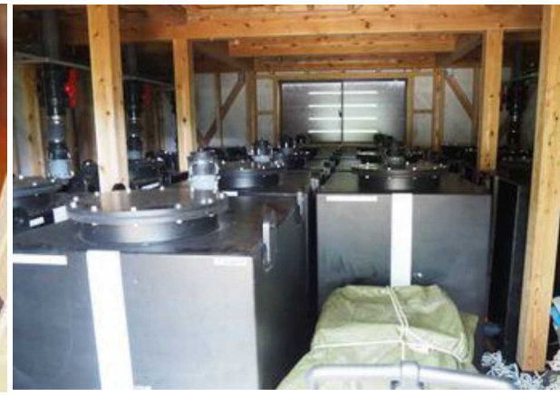
トイレ床下（カートリッジ）
