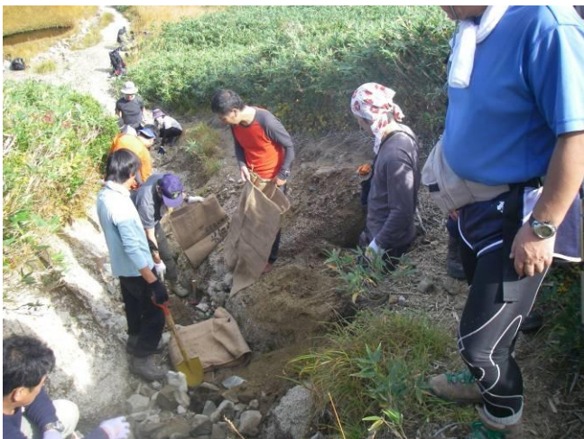
土嚢袋による土留め工の設置（梶川尾根・フキアゲ沢源頭）
