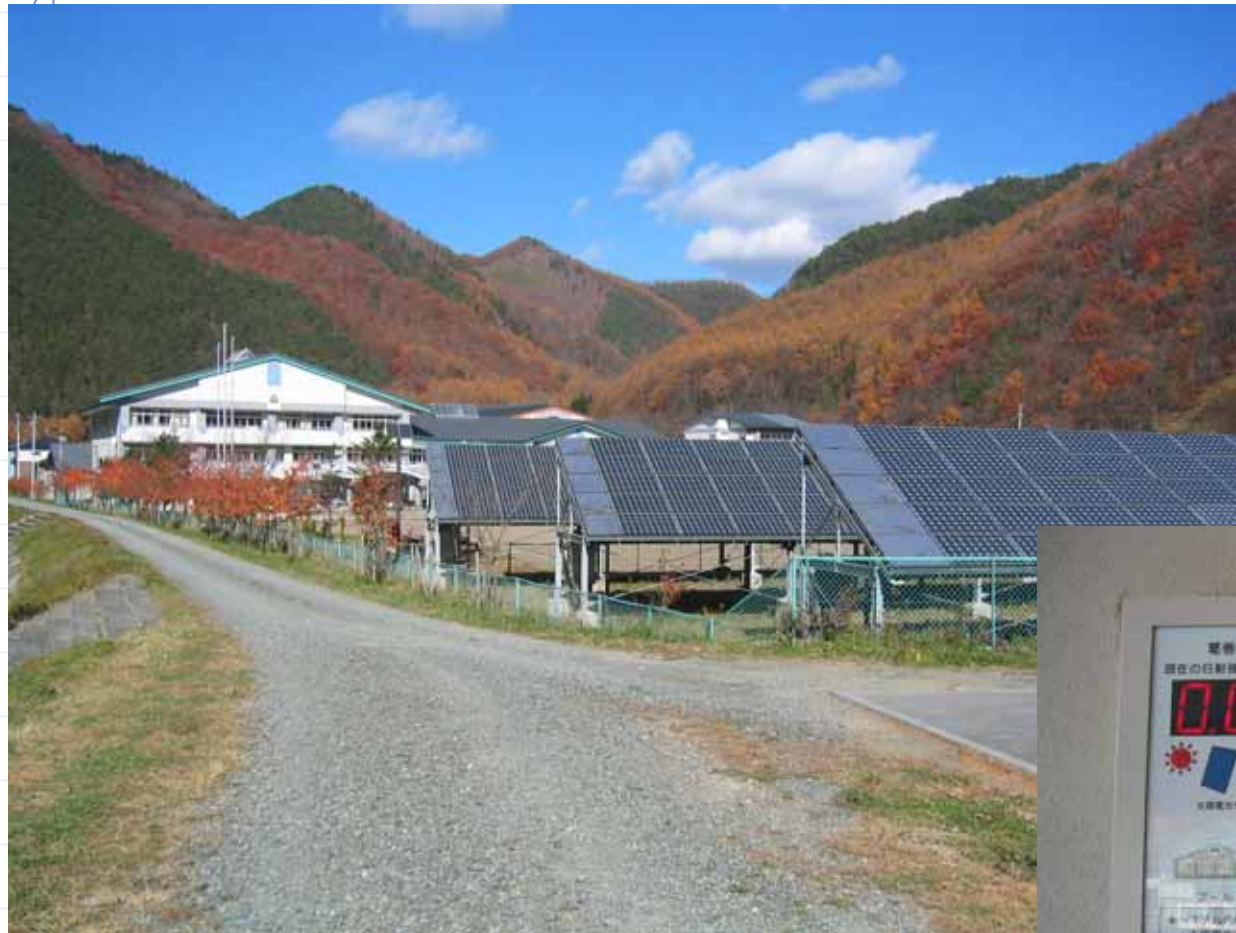
葛巻中学校太陽光発電設備 (50kW)
