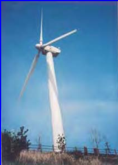
田原市 300kW 高さ45m 直径29m
