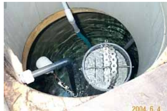
最終貯留室 (中水)
