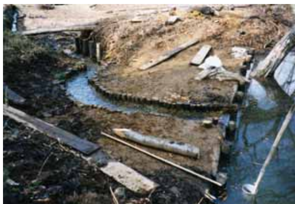
伝統的工法により整備された水路
